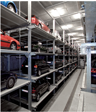
Ein Blick in den Multiparker 740 mit seiner zwei-reihigen Anordnung neben den Regalbediengeräten: Vier Parkebenen übereinander für insgesamt 284 Pkw unter der Straße.
